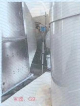
1#废气有组织排放处理前检测口 G9
