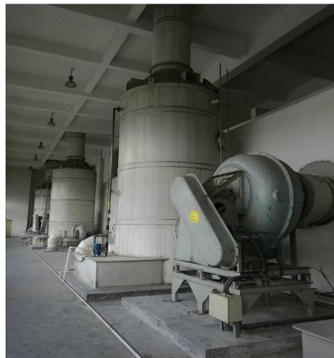
废气处理设施
