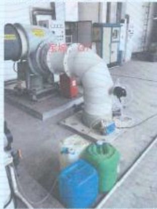
2#废气有组织排放处理前检测口 G7
