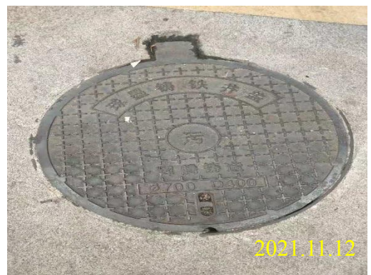
项目污水井盖
