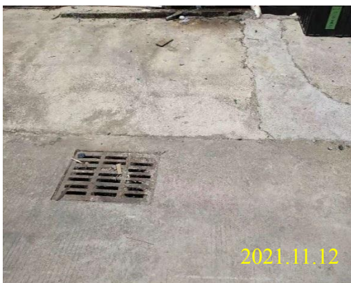
项目雨水井盖
