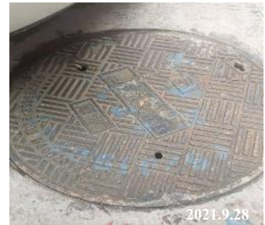
项目所在地雨水井盖
