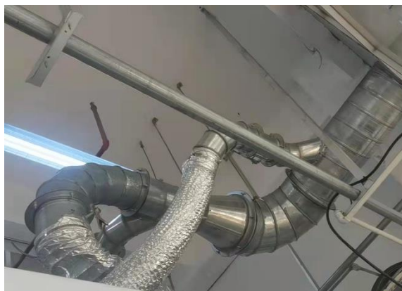
车间集气罩及收集管道
