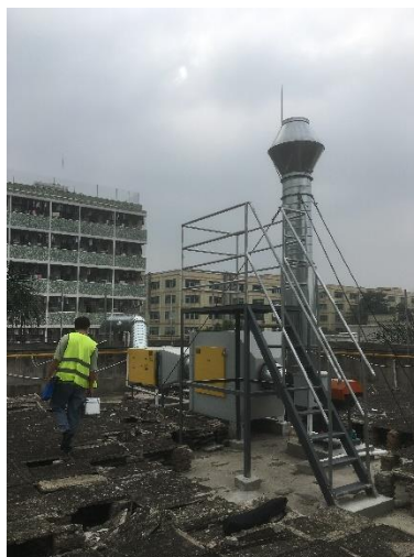
项目废气处理设施及排放口
