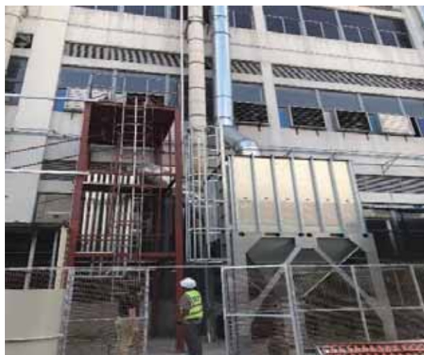
硅胶粉尘废气处理设施：“脉冲袋式除尘器”
