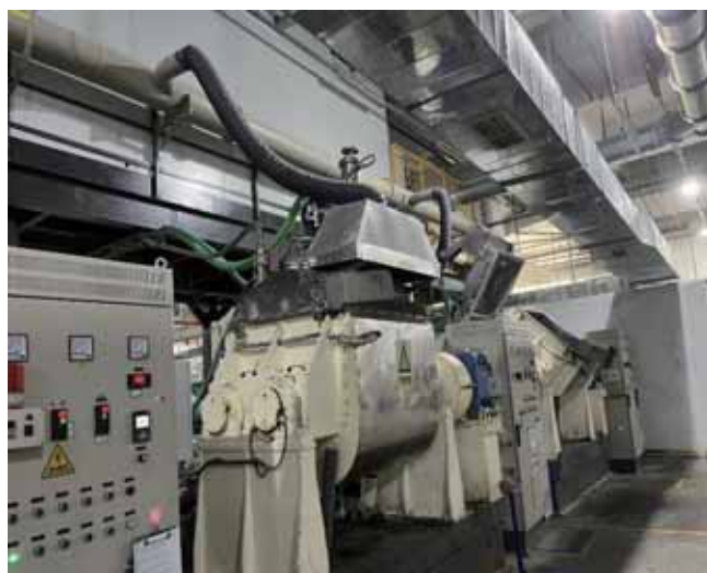
捏合工序集气管道
