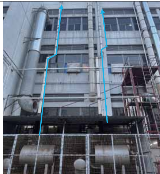
锅炉废气集气管道
