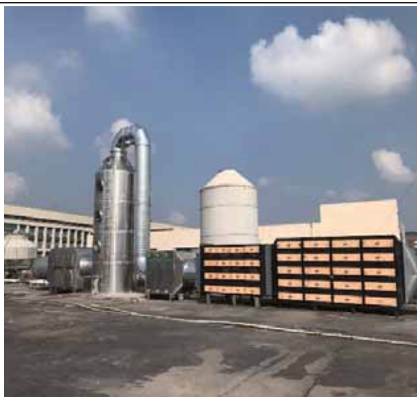
硅胶有机废气处理设施：“静电吸附+水喷淋+二级活性炭吸附”装置
